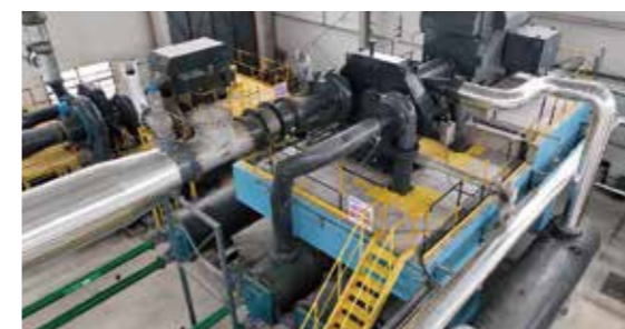
Установка на химическом заводе в Шаньдун
